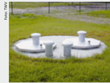
Brunnenschacht in der Schutzzone 1
